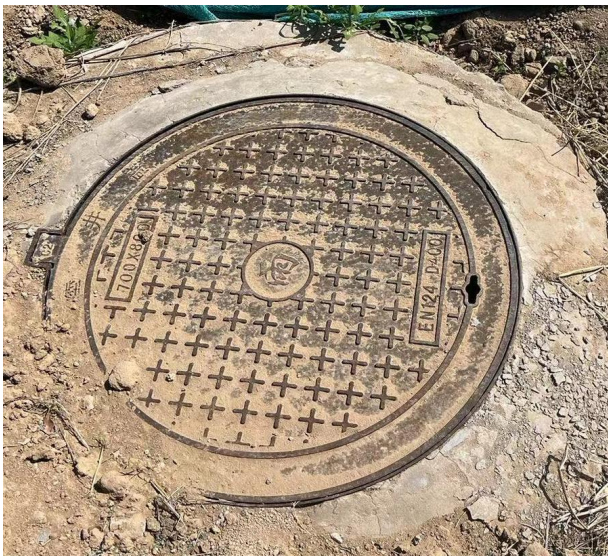
项目区内雨水井
