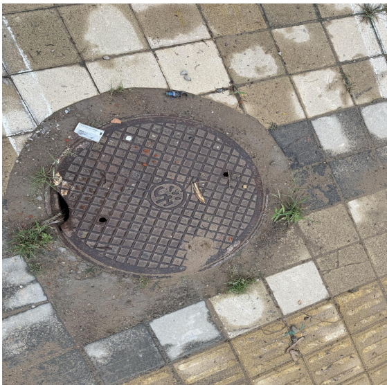
项目区内污水井
